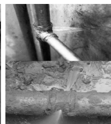
Système d'extincteurs automatiques
