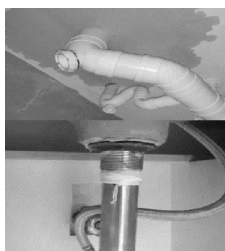
Fuites de tuyaux d'alimentation en eau/tuyaux d'eau
